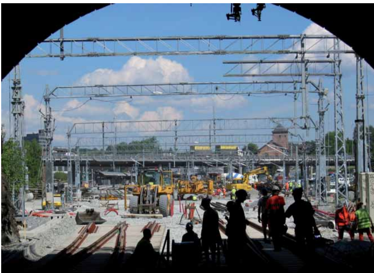
Figur 2.1: Store anlegg krever samarbeid på mange plan. Her ser vi et anleggsbilde fra den tiden da Asker stasjon ble bygget ut. Foto: Øystein Grue, Jernbaneverket
